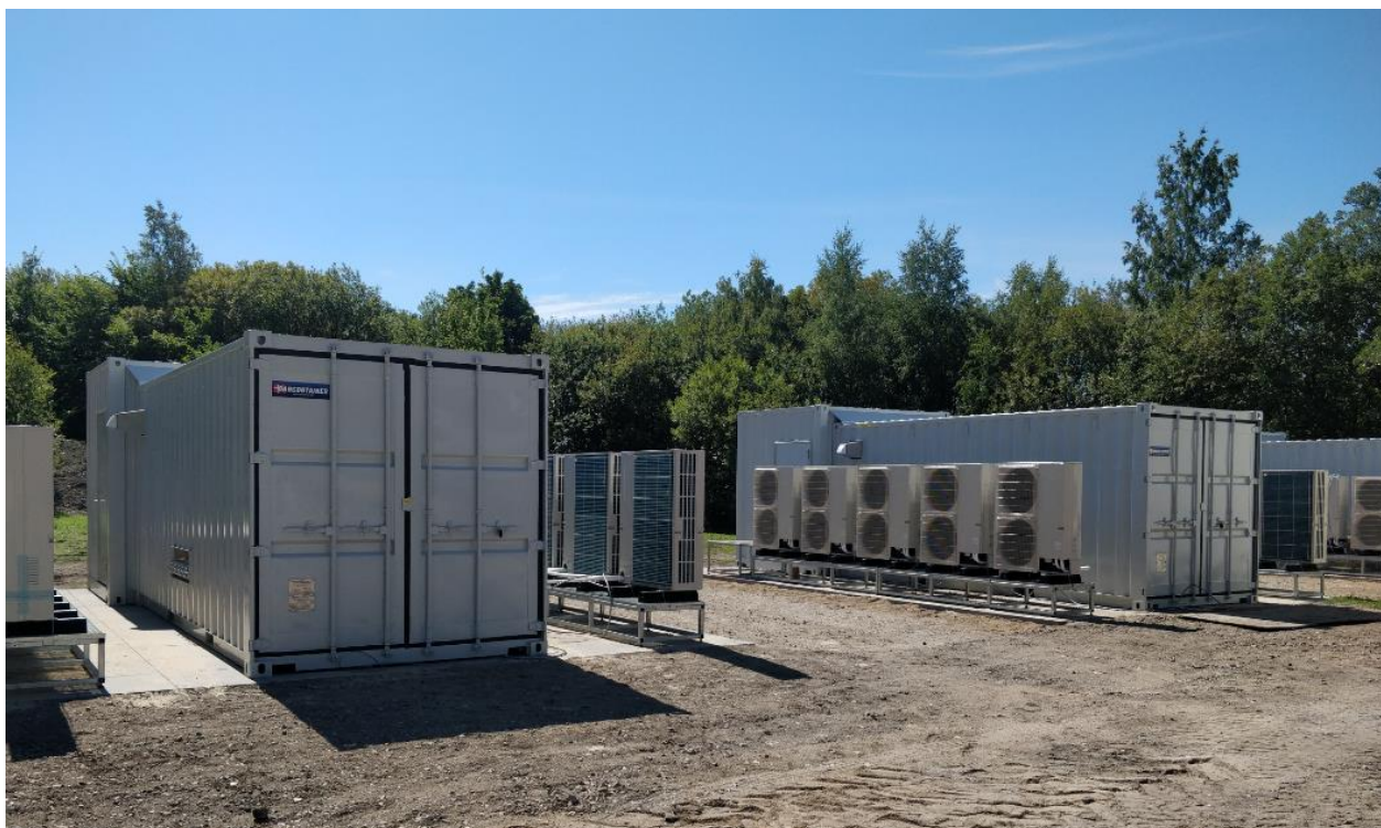
Figur 4.6: Eksempel på en containerløsning hos et dansk fjernvarmeværk
